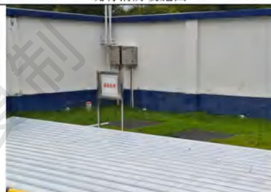
现有事故油池
