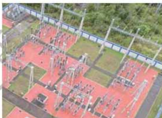
110kV 配电装置区
